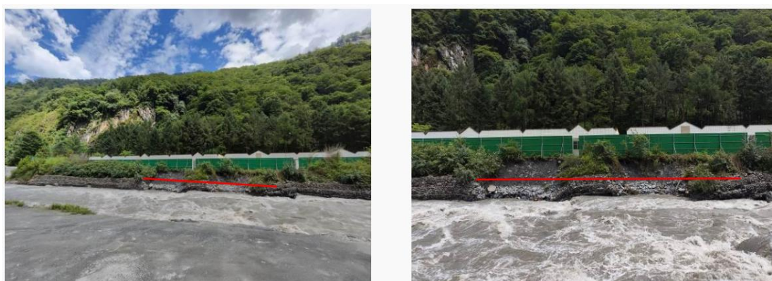
图 2-1-14 钢筋石笼损毁段全貌照（局部损毁，长 18 米）
