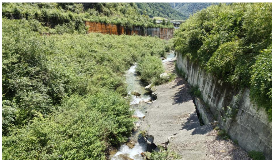
图 2-1-19 幸福沟河道右岸上游段防护堤基础掏空
