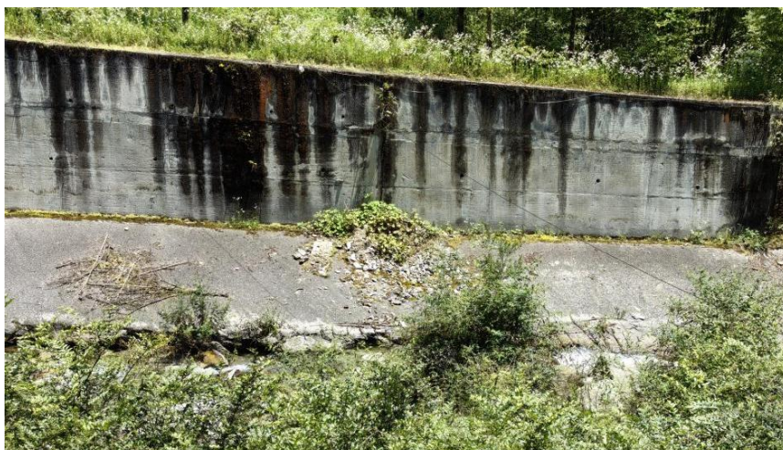
图 2-1-21 幸福沟河道右岸下游段防护堤基础掏空
