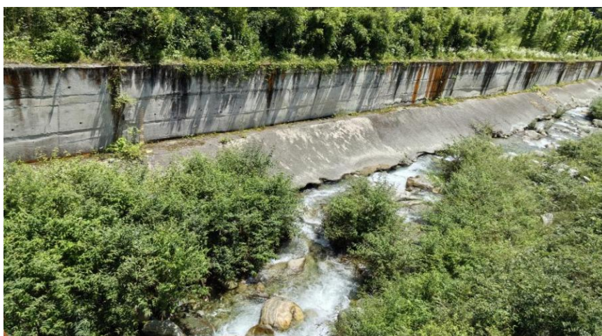
图 2-1-22 幸福沟河道左岸下游段防护堤基础掏空
